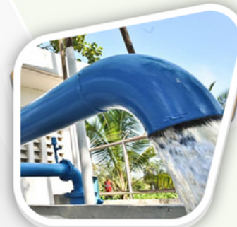
Air Bersih WTP
